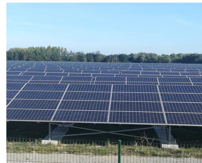
Photo 1 : installation fixe au sol
